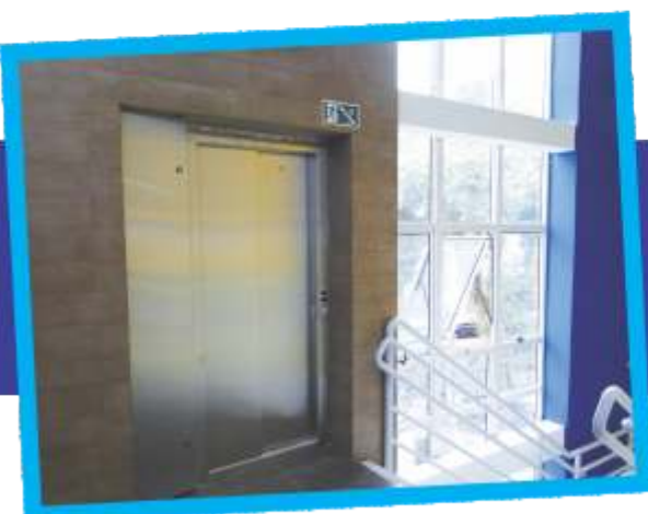
Elevador dá acessibilidade
